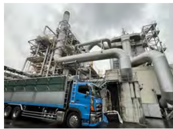
真庭バイオマス発電所
