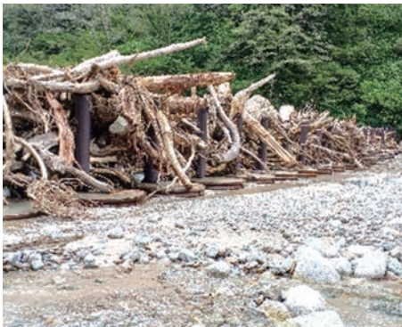
「流木捕捉工」による流木対策(富山署)
